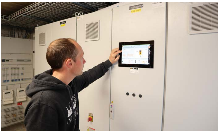
■ Lukas Frei, Vorstandsmitglied der Heizgenossenschaft Knonau, prüft die Werte.
